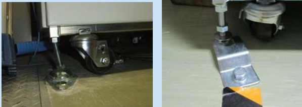
<キャビネットアンカーの損傷の一例>
