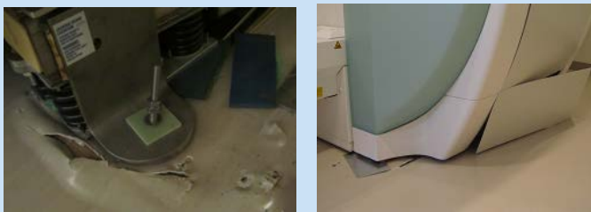
<架台の破損、マグネット移動の一例>
