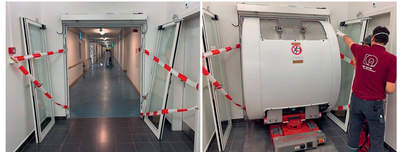
5 スイス・University Hospital BaselにおけるMAGNETOM Free.Maxの設置。第1号機の設置においても、クエンチパイプをなくした小型サイズのおかげで設置プロセスははるかに簡単になった。
